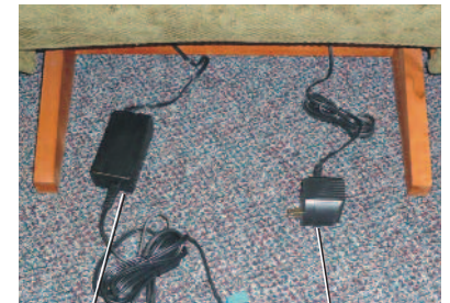
Transformador de energía de la cámara de refrigeración Transformador de energía para masaje y calor
