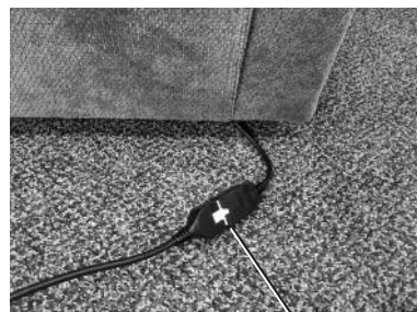
Connexion du transformateur
